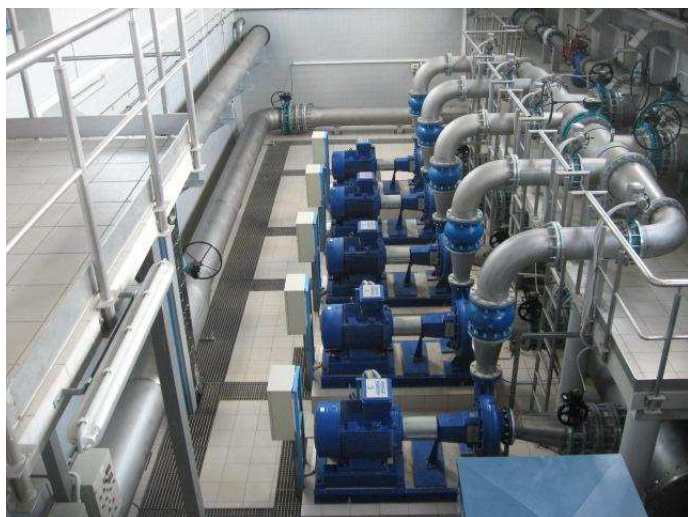
Fot. 3 SUW- Gruszczyn zespół pomp dystrybucyjnych
